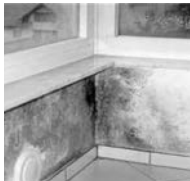
Schimmelbildung im Fensteranschlussbereich
