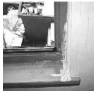
Durch Malerarbeiten verursachte Verunreinigung
