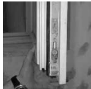
Weißkorrosion an Beschlagteilen
