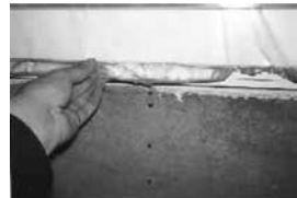
Tauwasseransammlung an mit Folie abgedecktem Fenster
